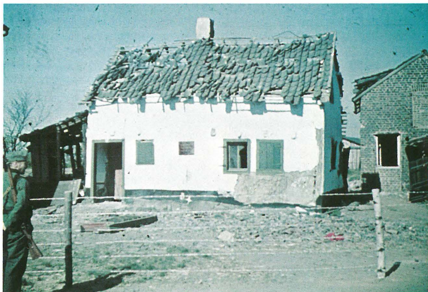
Auf einem für die damalige Zeit seltenen Dia hat Paul Bach festgehalten, wie die Schadenstelle an der Kuttgasse abgesperrt und bewacht wurde.
