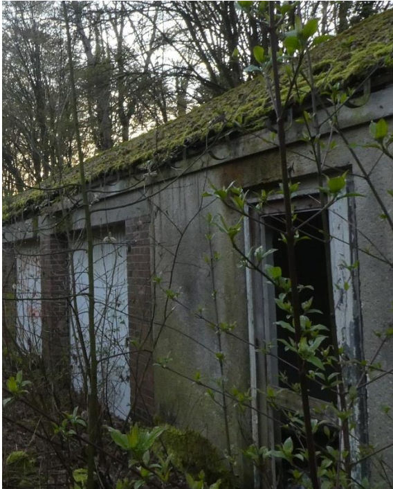
Abbildung 16: Ein- und Ausflugmöglichkeiten für Fledermäuse in die Garagen, Spalten unter dem Dach.
