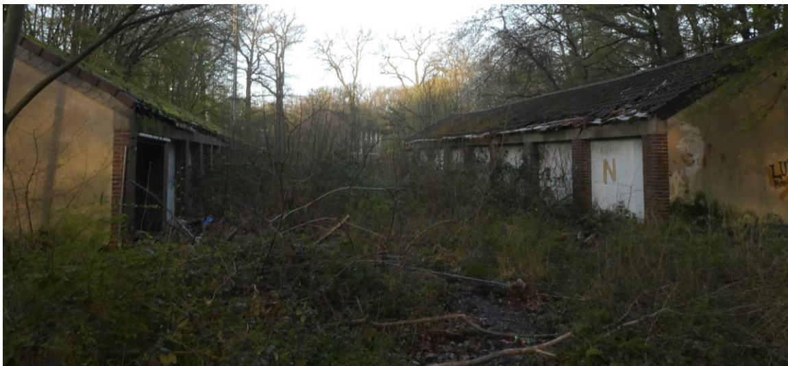
Abbildung 11: Der zum Abriss vorgesehene Garagenhof ist bereits stark verfallen. Im Garagenhof und umliegenden Bereichen hat sich bereits dichte Strauchvegetation etabliert. Der Garagenhof wird beschattet durch die umliegenden Gehölze mit geringem bis starkem Baumholz (östlicher Zugang).
